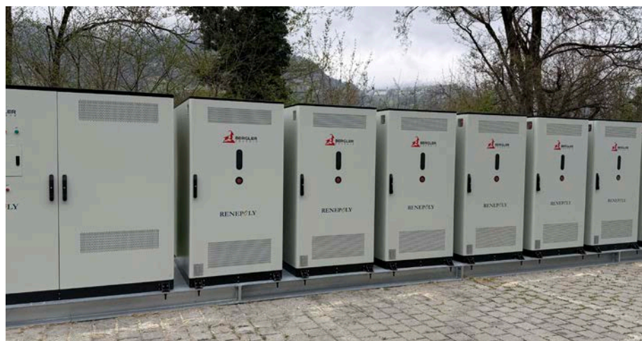
Hochleistungsbatteriespeicher in Maienfeld.
